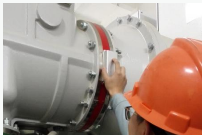
GIS 现场局部放电测试
